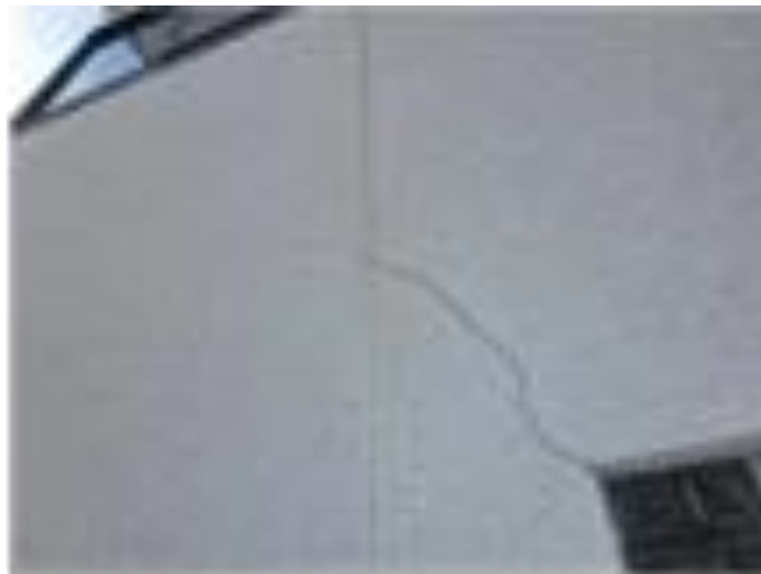
外壁のひび割れ
