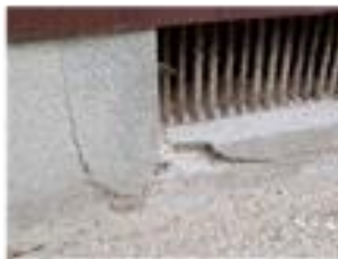
基礎立ち上がりの割れ
